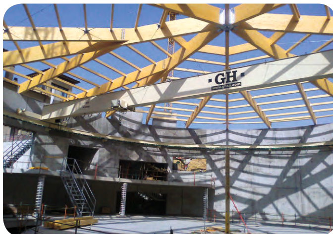
POLAR CRANE 环轨吊
